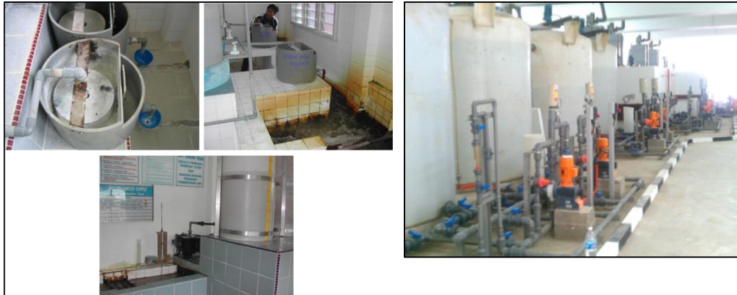
WTP < 1 MLD Gravity dosers
